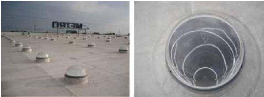
HÌNH . 7 4 Hệ thống ống lấy sáng mặt trời trên mái siêu thị Metro Hiệp Phú
