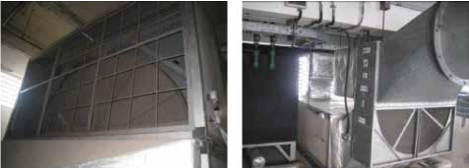
H Ì N H . 6 5 Cụm thu hồi nhiệt lắp đặt tại Vincom Center
