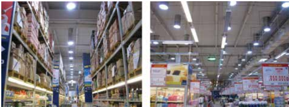
HÌNH . 7 3 Hệ thống chiếu sáng nhân tạo và ống lấy ánh sáng mặt trời bên trong siêu thị Metro Hiệp Phú
